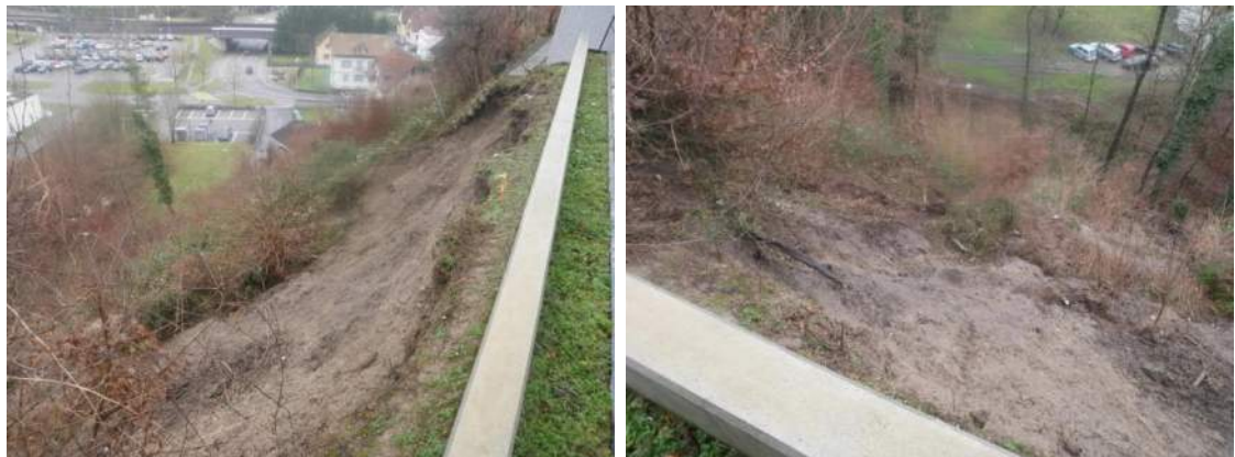
Fotoserie 3: Rutschung oberhalb Teufelsweglein
